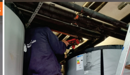
Manutenção de Equipamentos
