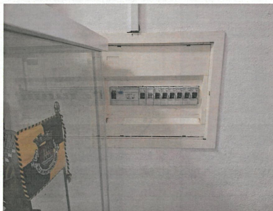
Fig. 3 — Quadro existente embutido, com aparelhagem antiga e sem reserva de espaço para ampliação.
