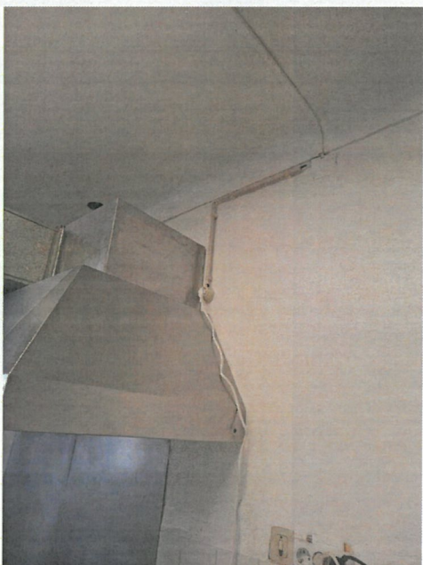
Fig. 11 — Exaustor da zona de bar alimentado por cabo volante e ficha; canalização e aparelhagem salientes.
