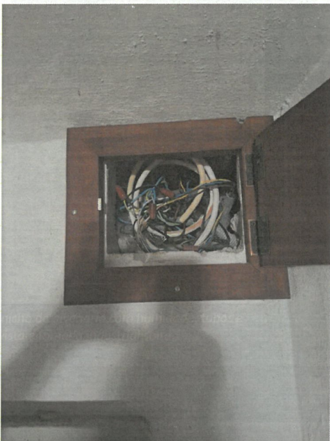
Fig. 7 — Outra vista da caixa de derivação: condutores antigos e recentes misturados, sem proteção adequada.
