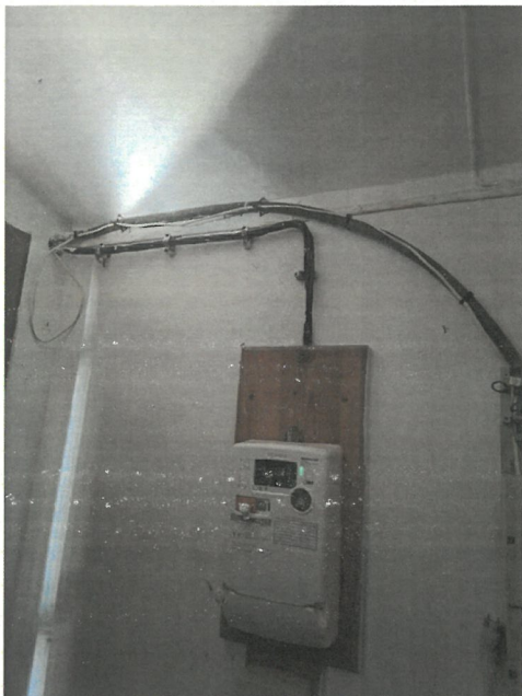
Fig. 13 — Contador de energia sobre tábua de madeira, com canalização saliente e condutores soltos.
