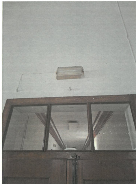
Fig. 14 — Iluminação sobre a entrada do salão alimentada por condutor saliente; ao fundo, instalação à vista no salão.
