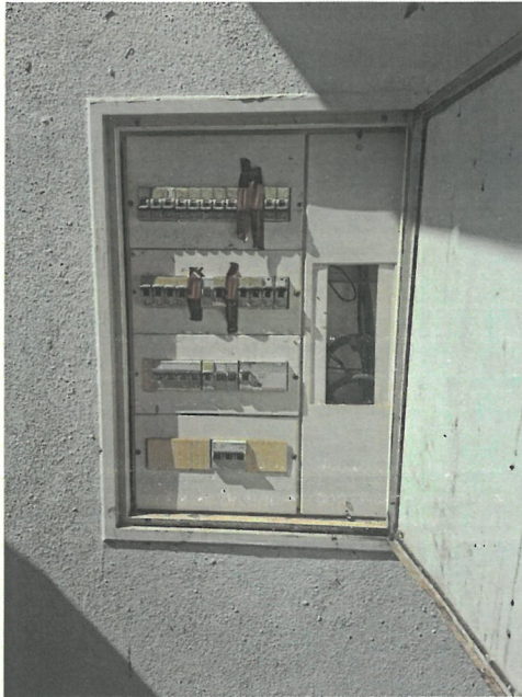
Fig. 5 — Quadro exterior com disjuntores isolados com fita adesiva e ligações precárias.
