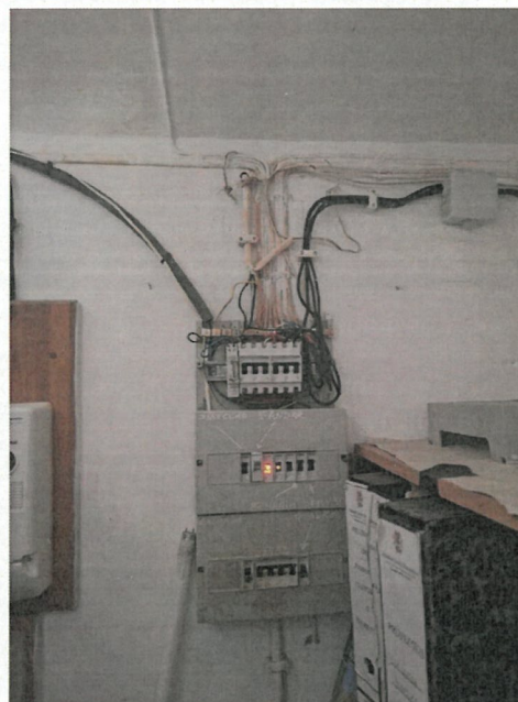
Fig. 2 — Conjunto «Quadro Geral / Direcção / camarim / bilhar»: terminais a descoberto e cablagem antiga emaranhada.
