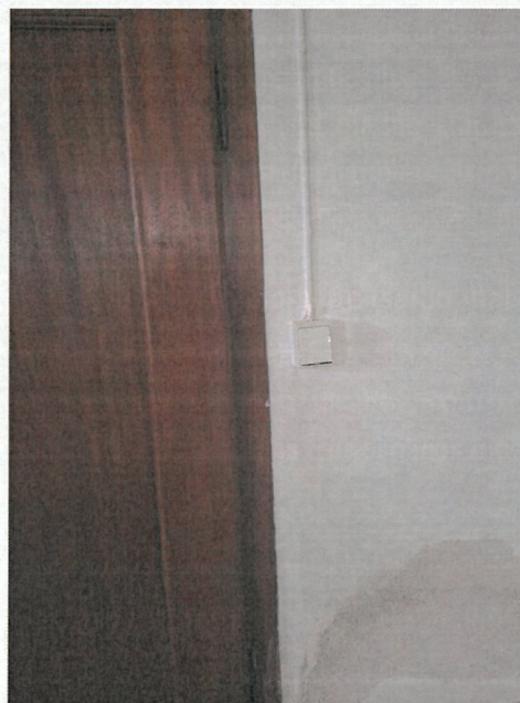
Fig. 12 — Aparelhagem e canalização salientes junto a parede com sinais visíveis de humidade.
