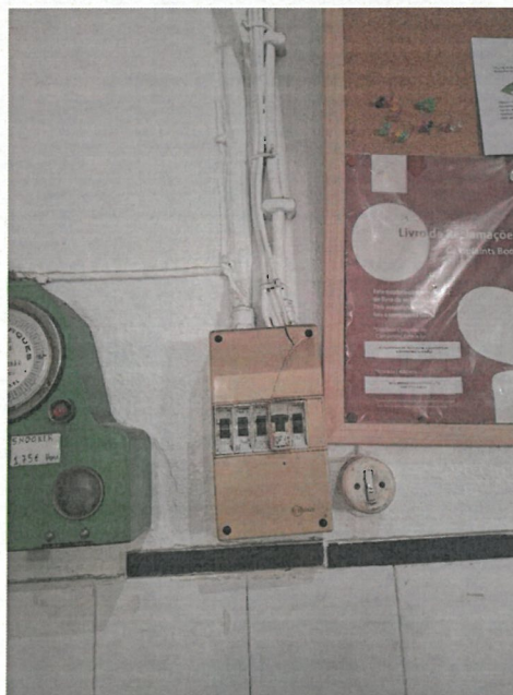
Fig. 4 — Quadro da zona de bar/jogos com a caixa partida e fissurada, junto a aparelhagem antiga.
