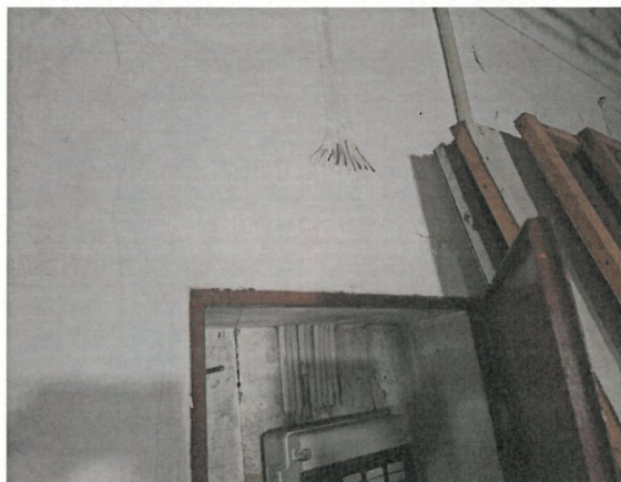
Fig. 10 — Esteira de tubo cerâmico antigo a descer para o nicho do quadro; alvenaria à vista e fissuras na parede.
