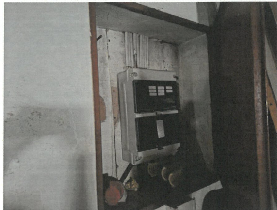
Fig. 8 — Quadro em nicho de alvenaria com humidade, tubos e cabos à vista e tomada industrial solta.
